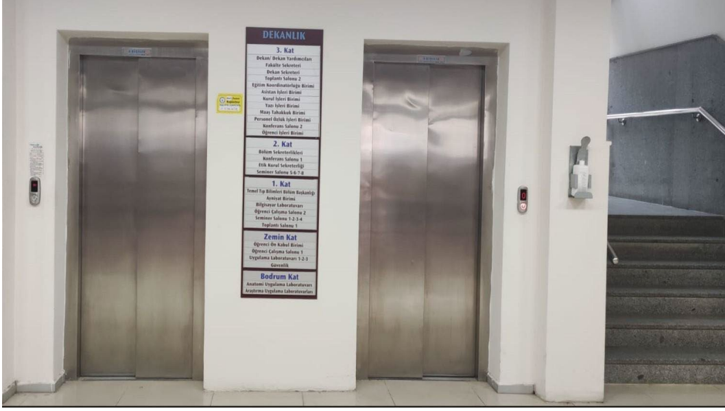
Fotoğraf TS 7.1.7./3. Dekanlık Binası Asansörleri
