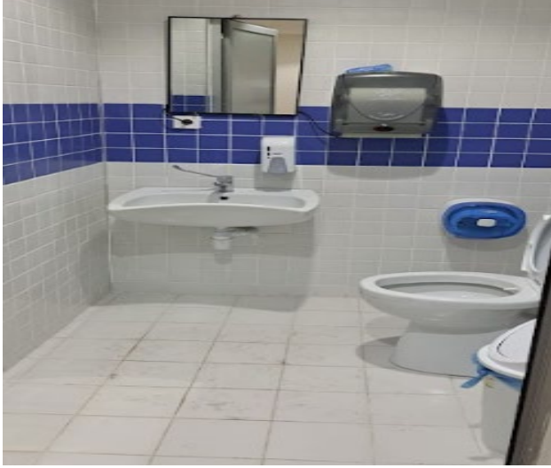
Fotoğraf TS 7.1.7./1. Dekanlık Binası Engelli Tuvaleti
